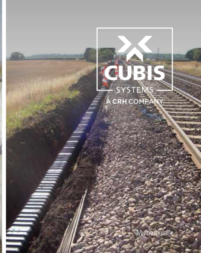
Caniveau à câbles
